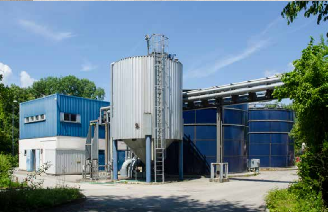
Die biologische Abwasserreinigungsanlage auf dem GSB-Gelände in Ebenhausen-Werk.
